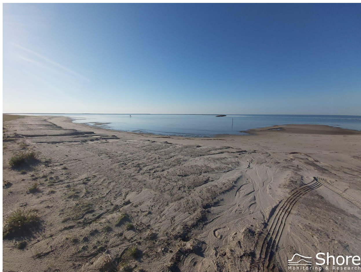
Figure 6.13: Lopen voor overlap (achtergrond). Eroderende kleilaag door regenafvoer (voorgrond). Bij oostlijke kant D4.
