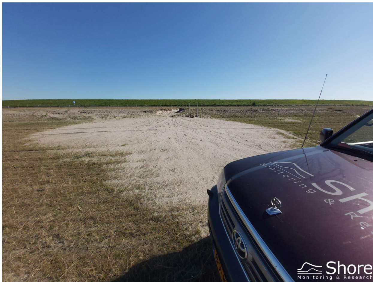
Figure 6.15: Eroderende kleilaag, ook zand wordt meegevoerd, door regenafvoer. MMzijde.
