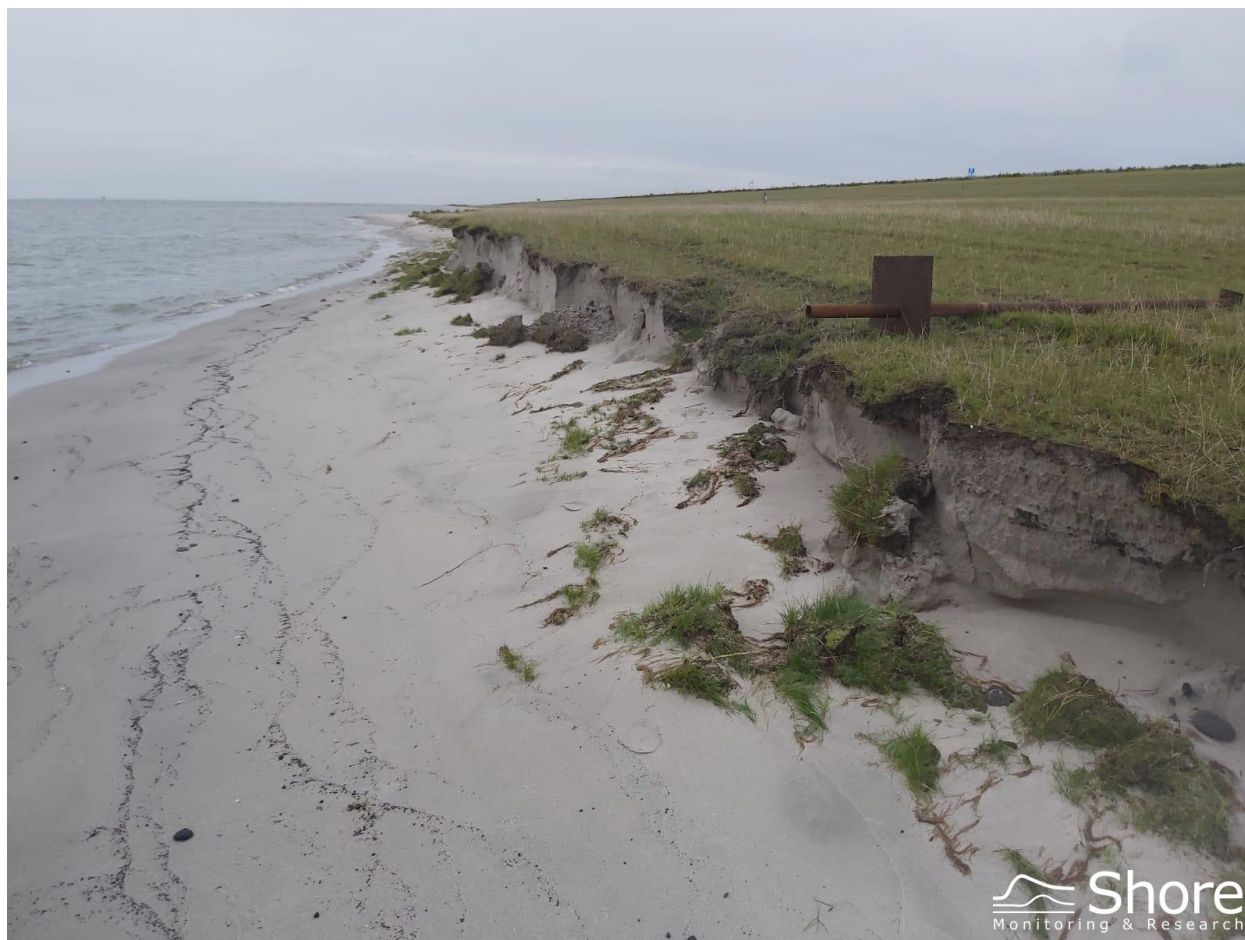
Figure 6.16: Klifvorming IJsselmeerkant nabij Enkhuizen (D1- west), kijkend richting oosten
