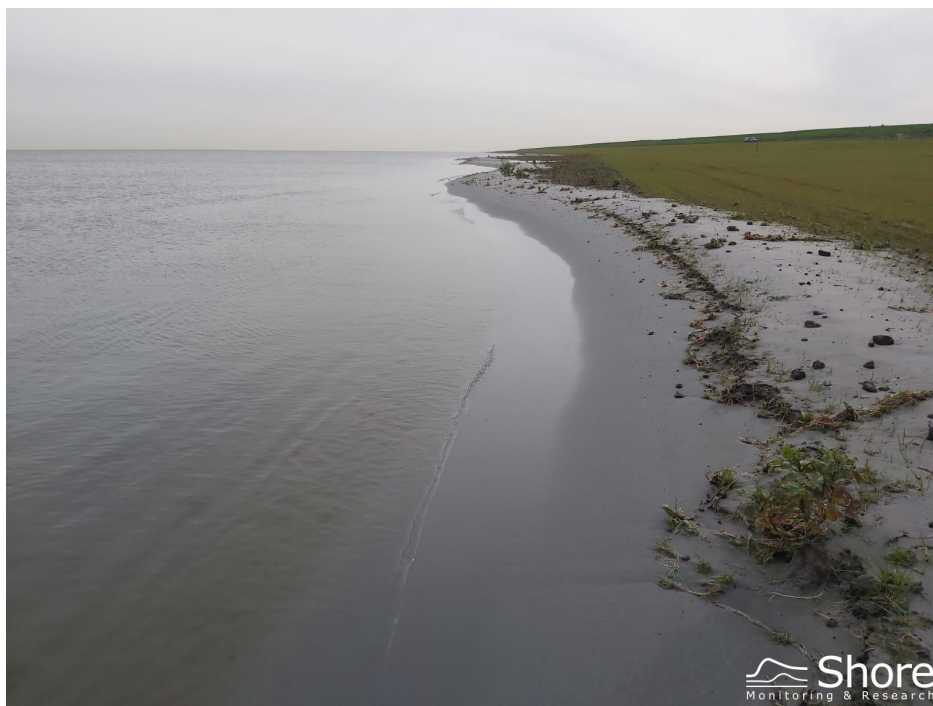
Figure 6.3: Erosie grasmat/waterlijn aan IJM zijde. Foto bij detailgebied 1 genomen.
