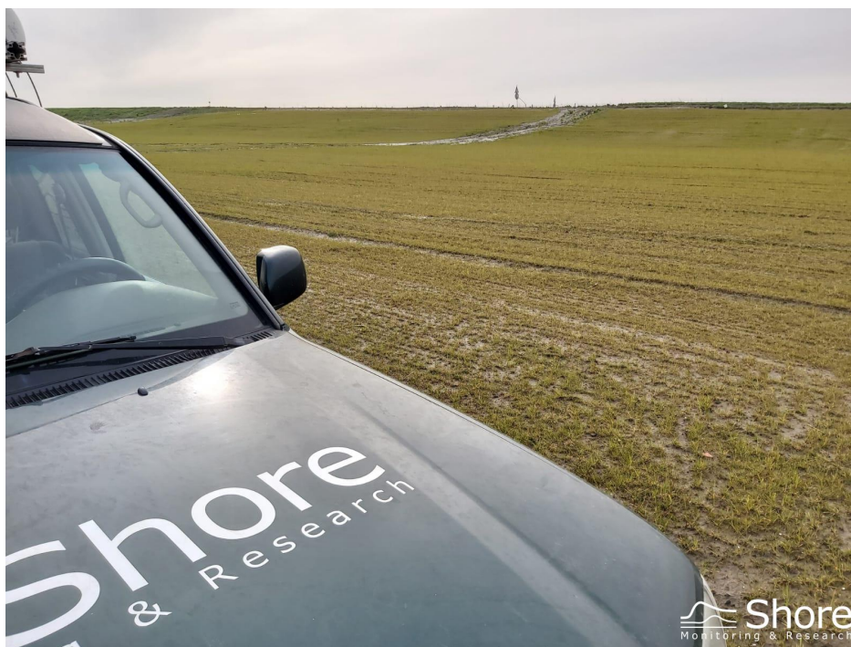
Figure 6.5: Erosie van toplaag versterking Houtribdijk, door regenwater afvoer.
