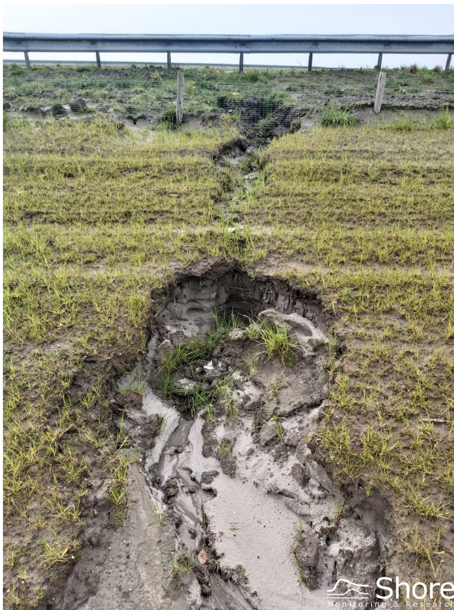
Figure 6.7: Erosie van toplaag versterking Houtribdijk, door regenwater afvoer.
