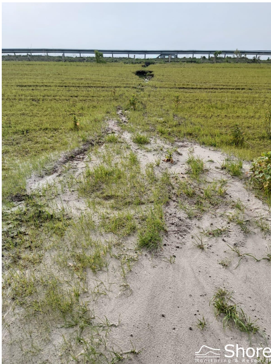
Figure 6.6: Erosie van toplaag versterking Houtribdijk, door regenwater afvoer.
