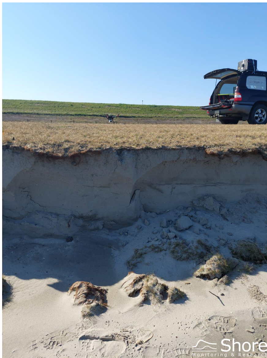
Figure 6.4: IJsselmeerszijde, erosie van de zandige dijkversterking. Waar nabij Enkhuizen een klif ontstaat van circa 1 meter hoog.
