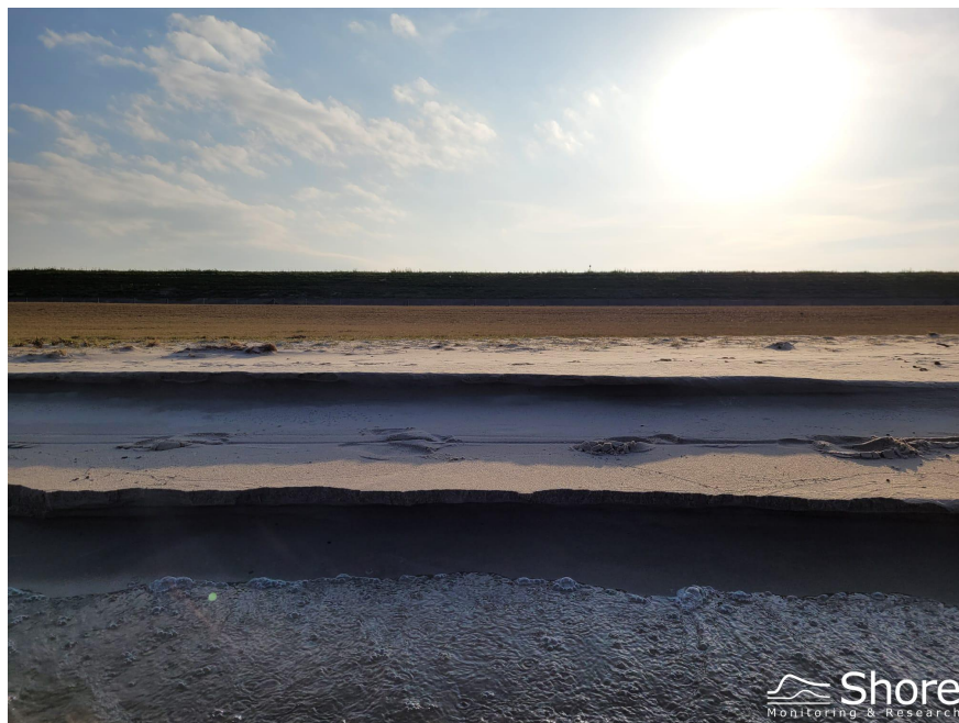
Figure 6.1: IJsselmeerzijde, erosie van de zandige dijkversterking.
