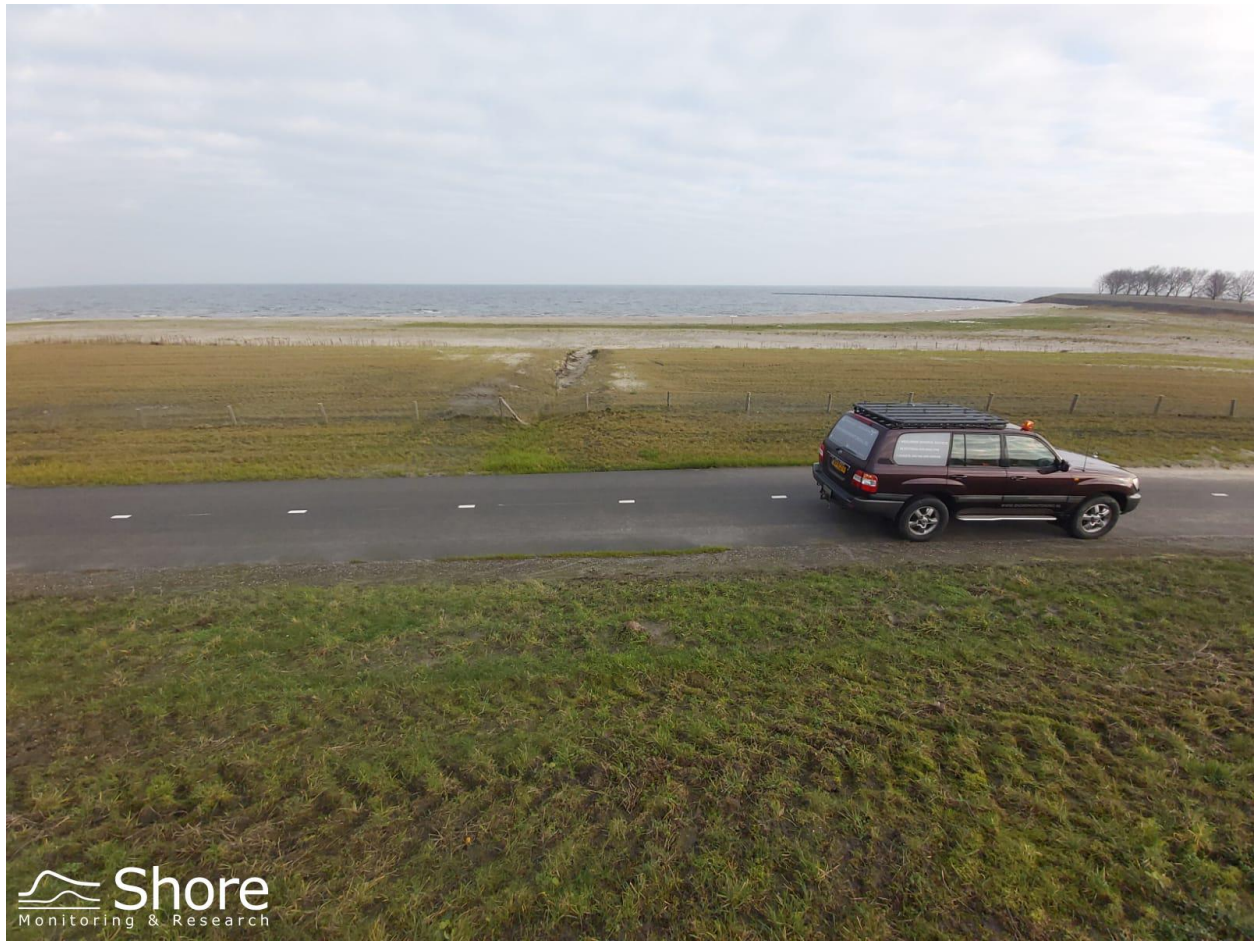
Figure 6.20: Vanaf het fietspad aan de IJsselmeerzijde, nabij Trintelhaven is flinke uitschuring door regenwater afvoer opgetreden.
